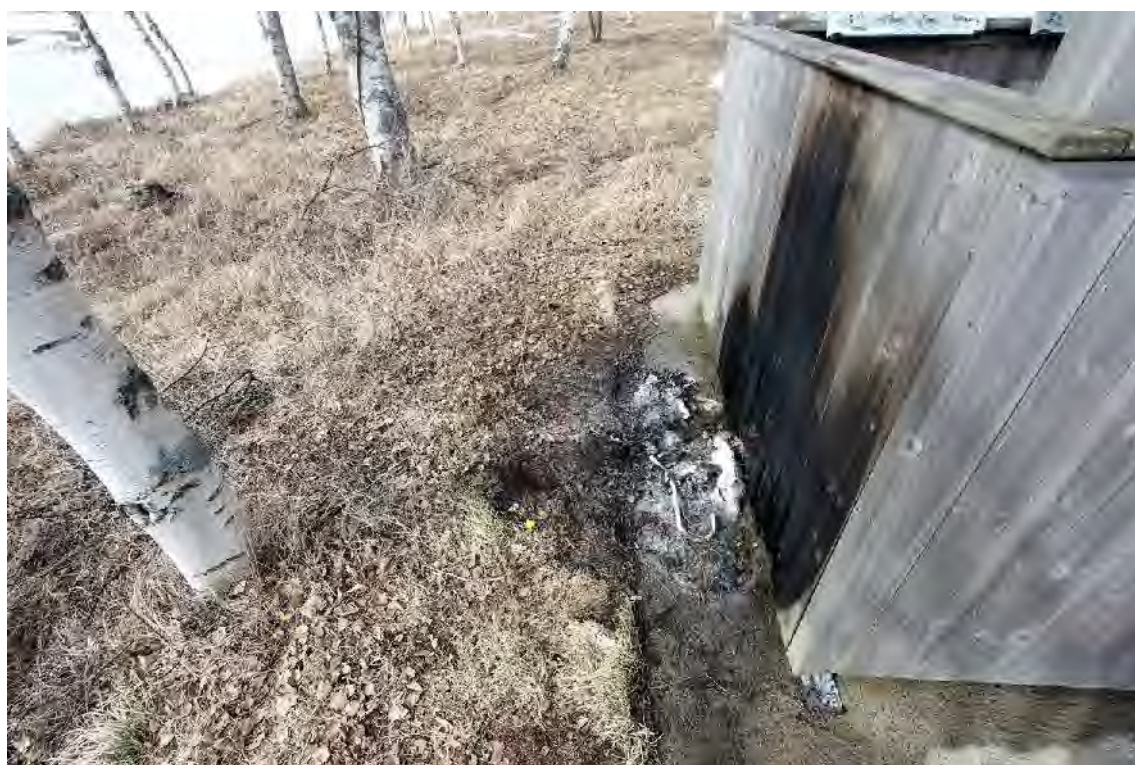
Bild 4. Brandplatsen vid utkikstornet.
